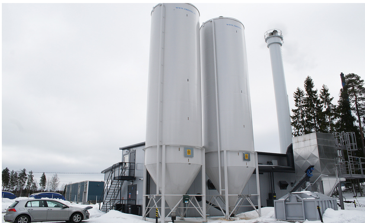
↑ Laitosrakennus toimitettiin kahtena moduulina. Erikseen näistä sijaitsevat pellettisiilot, savukaasujen pussisuodatin sekä piippu.
